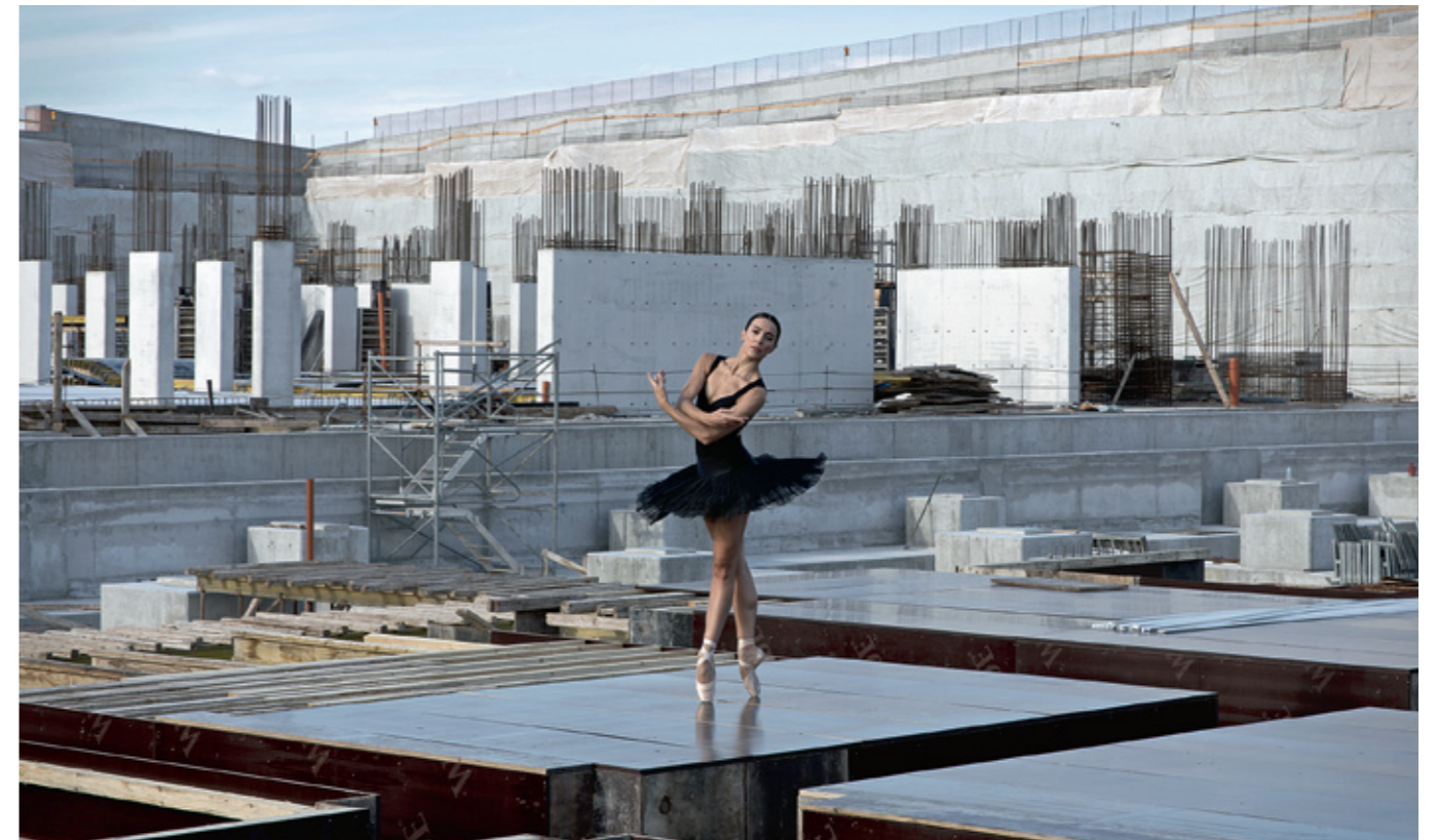
Κατά τη διάρκεια των εργασιών θεμελίωσης στο κτίριο της Εθνικής Λυρικής Σκηνής. Πίσω διακρίνεται ο λόφος του Πάρκου Σταύρος Νιάρχος στο τελικό του ύψος, Οκτώβριος 2013 / During the construction of the Greek National Opera building's foundations. In the background, the hill of the Stavros Niarchos Park at its final height, October 2013
